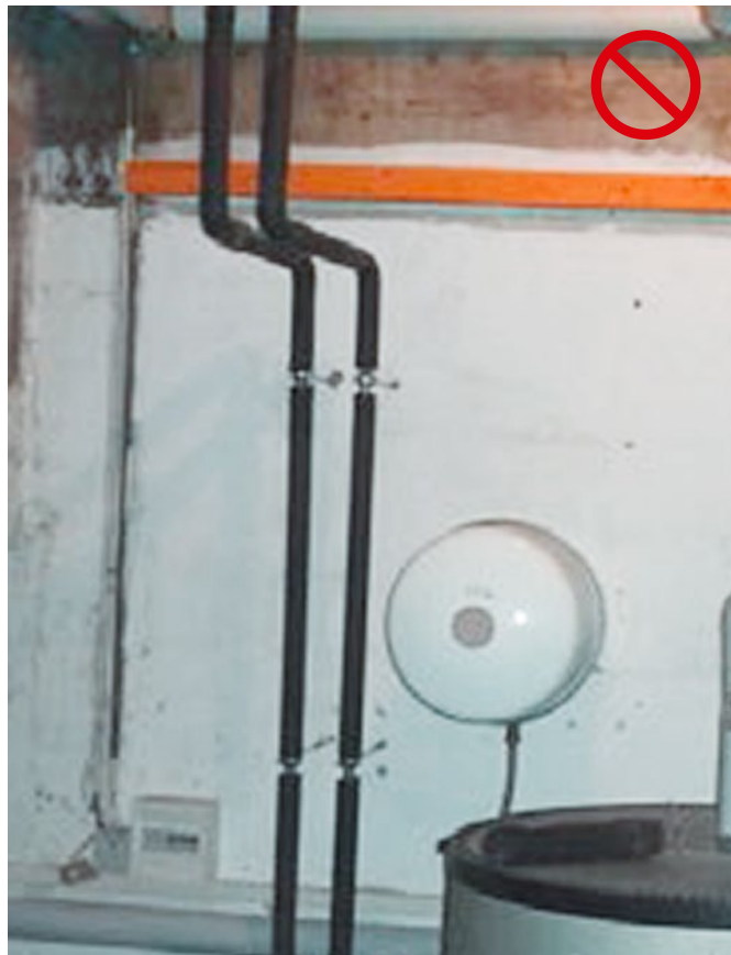
[ABB. 36] Hier geht viel Wärme verloren: lange Rohrleitungsführung im unbeheizten Innenraum. Lückenhaftes, stellenweise nicht fachmännisch angebrachtes elastomeres Dämmmaterial mit zu geringer Dämmstärke (ca. 13 mm), direkte Verbindung der unge-dämmten Rohrleitung zur Halterung (Wärmebrücke!).
