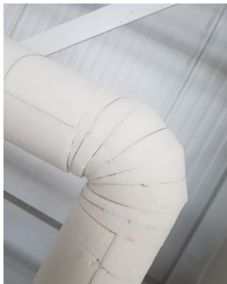
[ABB. 10] Bogendämmung aus segmentgeschnittenen PIR-Halbschalen.
