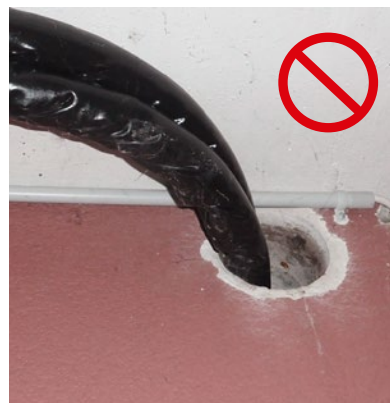
[ABB. 35] Unverschlossene Durchdringung vom Aussenraum in den Keller.
