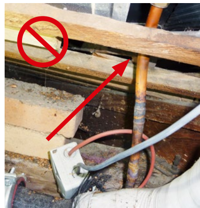
[ABB. 33] Holz in Kontakt mit heissen Rohrleitungen.
