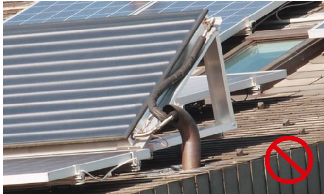
[ABB. 39] Das Dämmmaterial sackt nach unten ab. Es besteht die Gefahr, dass Regenwasser in das Umhüllungsrohr eintritt und ins Gebäudeinnere gelangt. Anschlüsse am Kollektor sind nicht gedämmt, Fühlerkabel ist verknäuelnd und der UV-Strahlung ausgesetzt.
