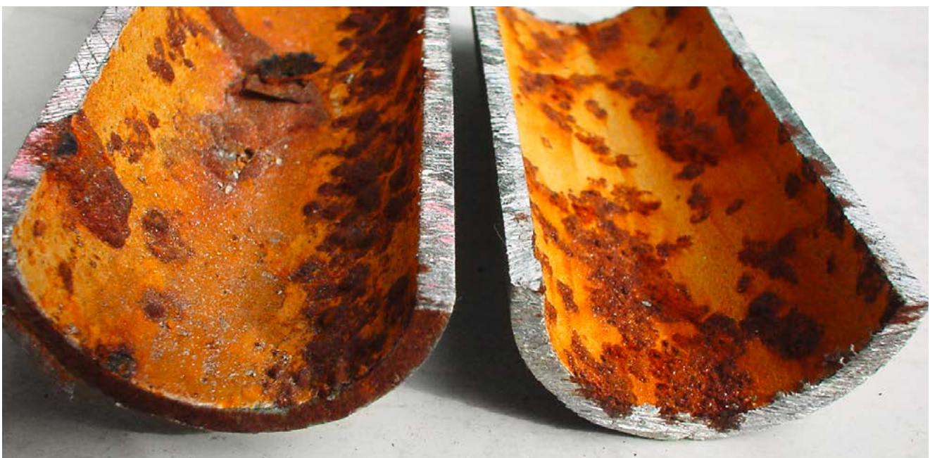
Korrosion in Heizungsrohren
