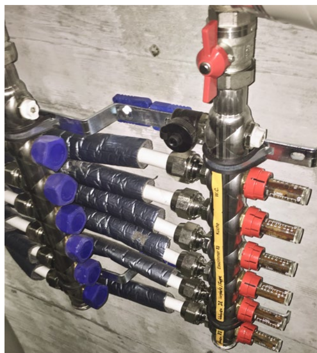
[ABB. 3] Verschmutzte Durchflussanzeiger nach zwei Betriebsjahren.
