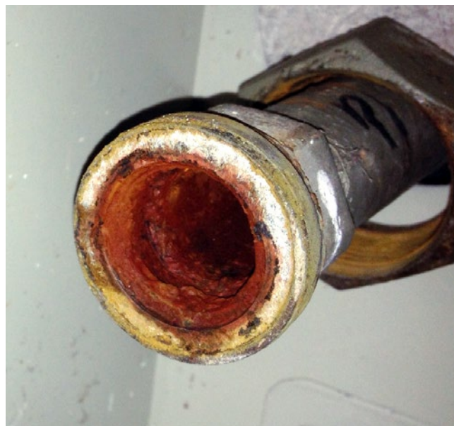
[ABB. 2] Fussbodenheizungsverteiler: Korrosionsrückstände.
