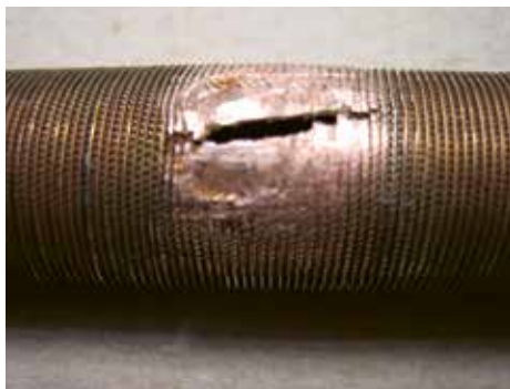
Bild 9.15: Rohrbruch aufgrund eines eingefrorenen Verdampferkreises (Frostschaden).
