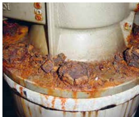
Bild 8.29: Korrosionsschäden an Kaltwasserleitung (unter der Dämmung).
