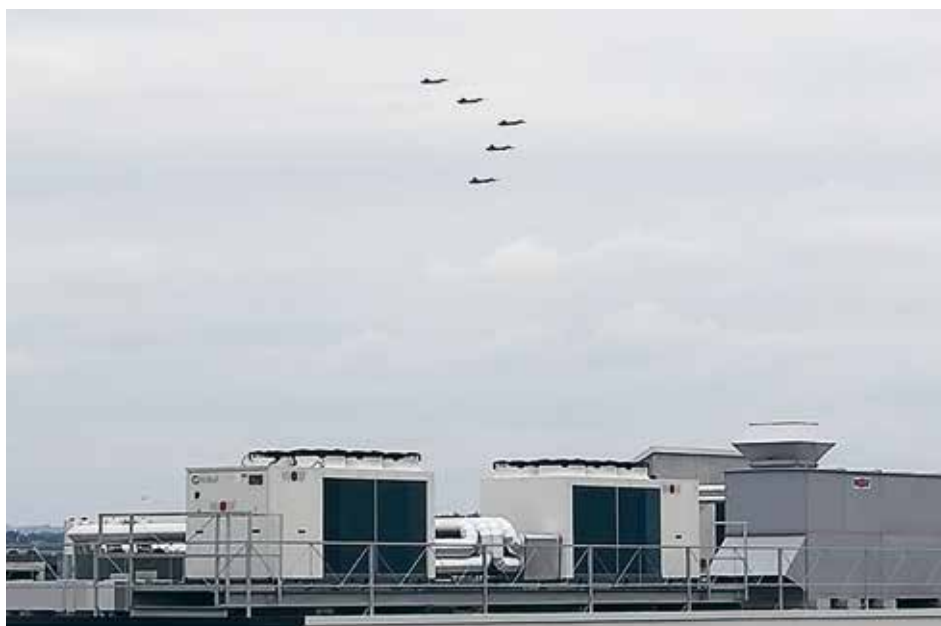
Bild 7.7: Kompakter Kälteerzeuger direkt auf dem Dach aufgestellt. (Bild: Wolf Schweiz AG)
