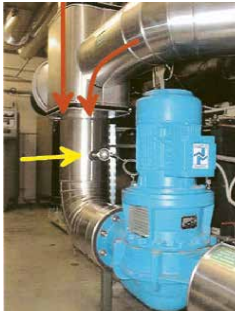
Bild 9.22: Falsch platzierter Messfühler unmittel- bar direkt nach dem Mischventil und vor der Pumpe. Das Versetzen des Fühlers nach Inbe- triebnahme der An- lage ist aufwendig.
