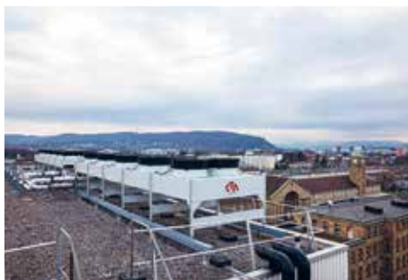
Bild 7.15: Trockenrückkühler auf dem Dach. (Quelle: CTA)
