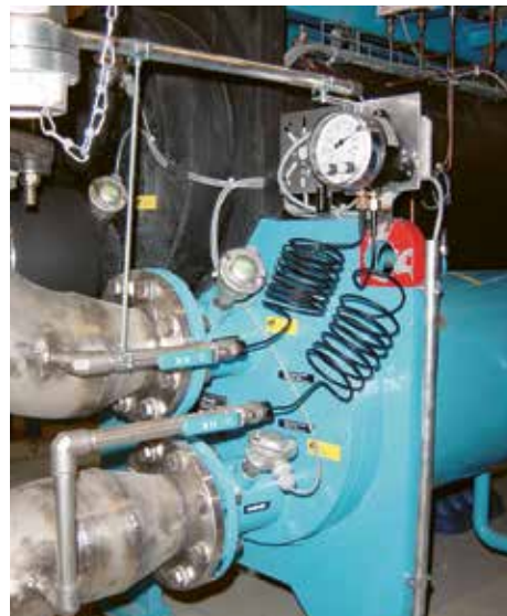
Bild 9.16: Mit der Strömungsüberwachung mittels Differenzdrucküberwachung kann der Durchfluss über den Verdampfer gemessen und so vor dem Einfrieren geschützt werden. Gleichzeitig wird so die Druckdifferenz angezeigt.
