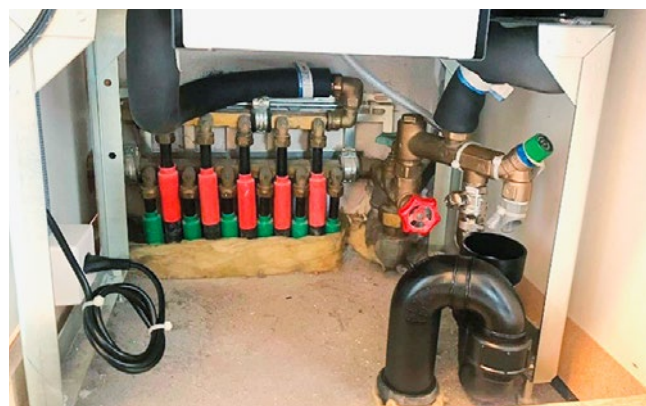
ABB. 4 Installation unter dem Wärmepumpen-Wassererwärmer.
