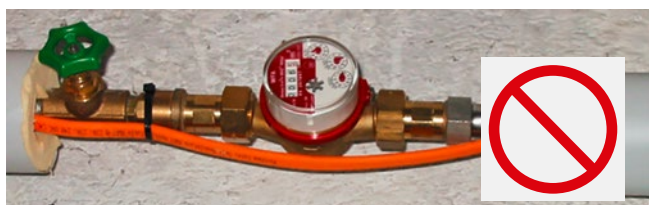
[ABB. 3] Das Warmhalteband sollte unten an der Rohrsohle installiert und gedämmt werden.
