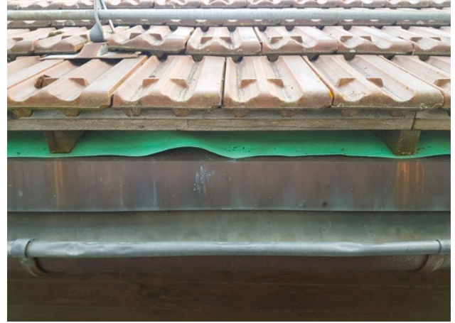
Bild 17: Ungenügend geschützte Unterdachbahn
