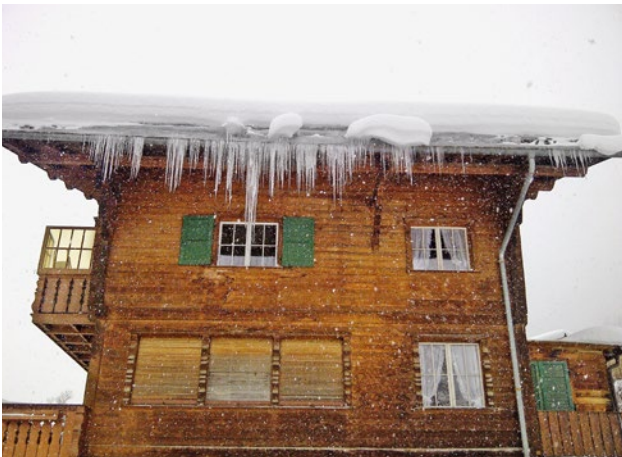
Bild 15: Eiszapfen aufgrund von Rückschwellwasser
