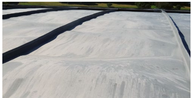
[ABB. 1] Aufblähung der Blechbahn durch Windkräfte aufgrund eines zu grossen Achsmasses.
