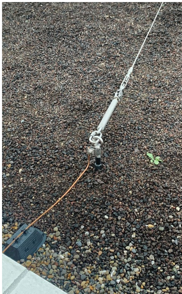
[ABB. 6] Angeschlossener Endpunkt beim Rückhaltesystem.
