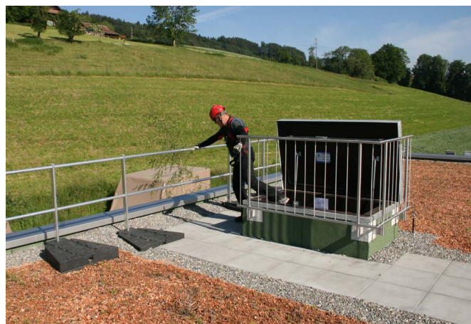
Abb. 36: Dachausstieg durch Seitenschutz aus dem Gefahrenbereich mit hoher Absturzgefahr gesichert. Optimal geplant würde der Dachausstieg in den inneren Gefahrenbereich führen
