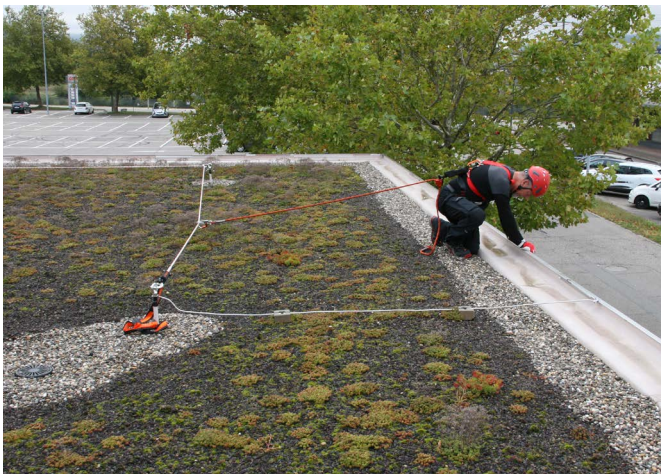
Abb. 3: Mitlaufendes Auffanggerät an beweglicher Führung als Verbindungsmittel zur Anschlageneinrichtung, manuell eingestellt, das einen Absturz verhindert
