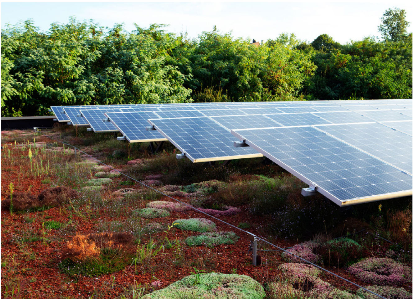
Abbildung 1: PV-Anlage kombiniert mit Extensivbegrünung, Quelle: contec
