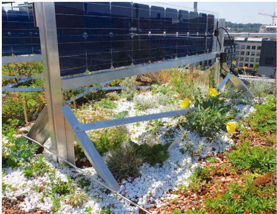
Abbildung 7: PV-Anlage mit bifazialen Modulen auf dem Dach der Seniorenresidenz Eichgut, Winterthur. Ein heller Untergrund mit silbrig-laubigen Pflanzen – wie Sonnenröschen und Thymian – begünstigt die Reflexion des Sonnenlichts und führt zu einem Mehrertrag in der Solarstromproduktion. Quelle: Solarspar
