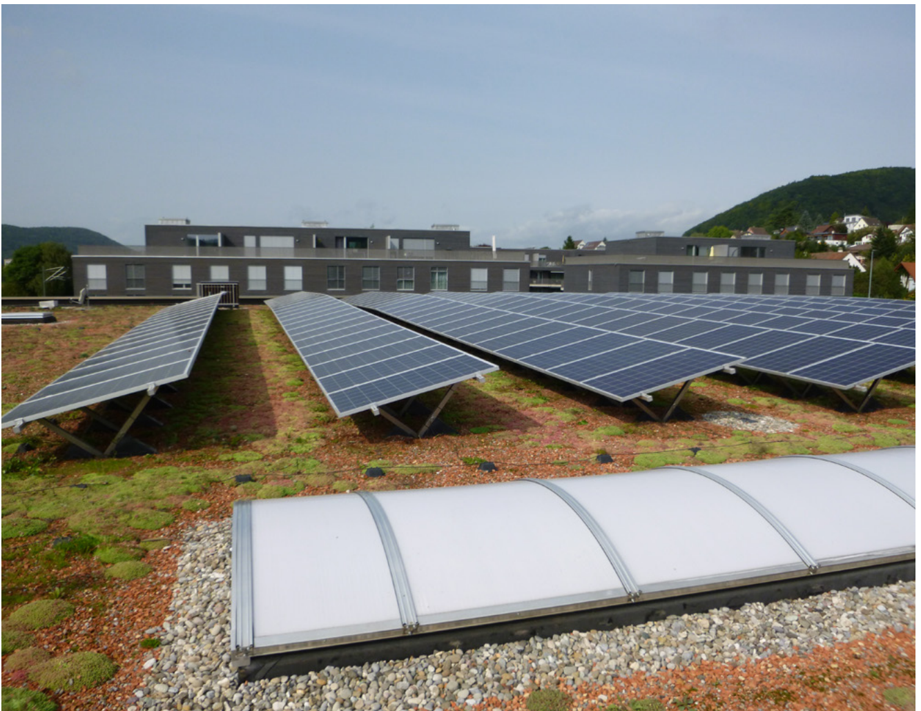
Abbildung 11: Gegen Süden ausgerichtete PV-Anlage mit minimalem Substrataufbau, Quelle: contec
