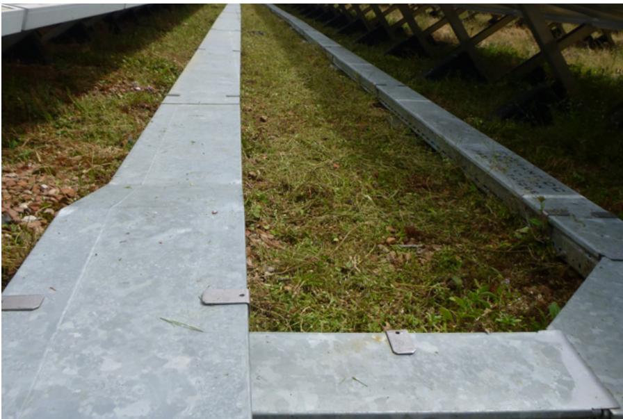
Abbildung 9: Kabelführung zwischen den PV-Modulen, Quelle: contec
