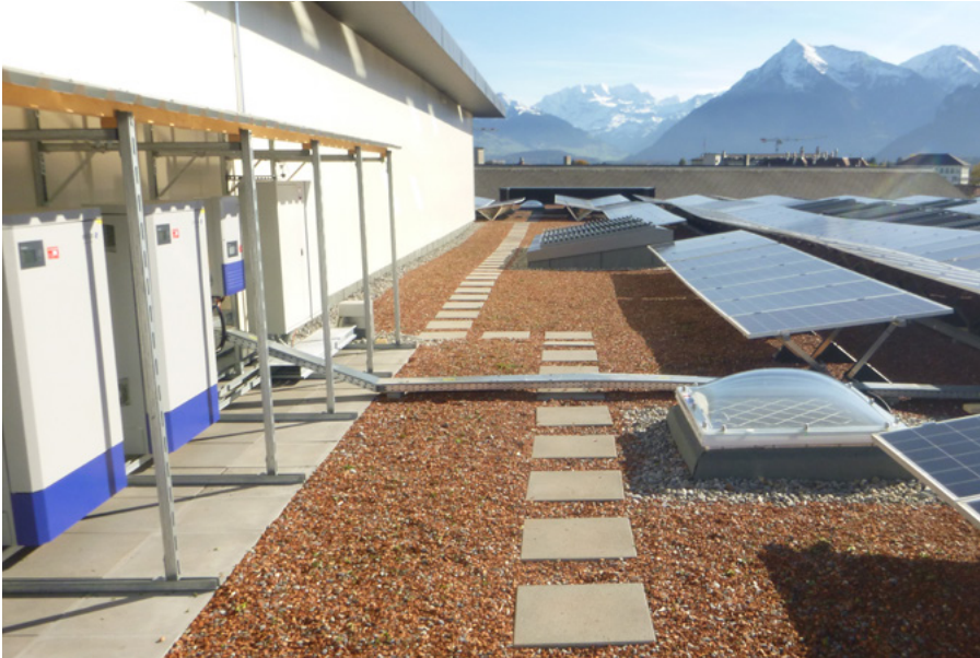
Abbildung 8: Kabelführung PV-Anlage zu Wechselrichter, Quelle: contec
