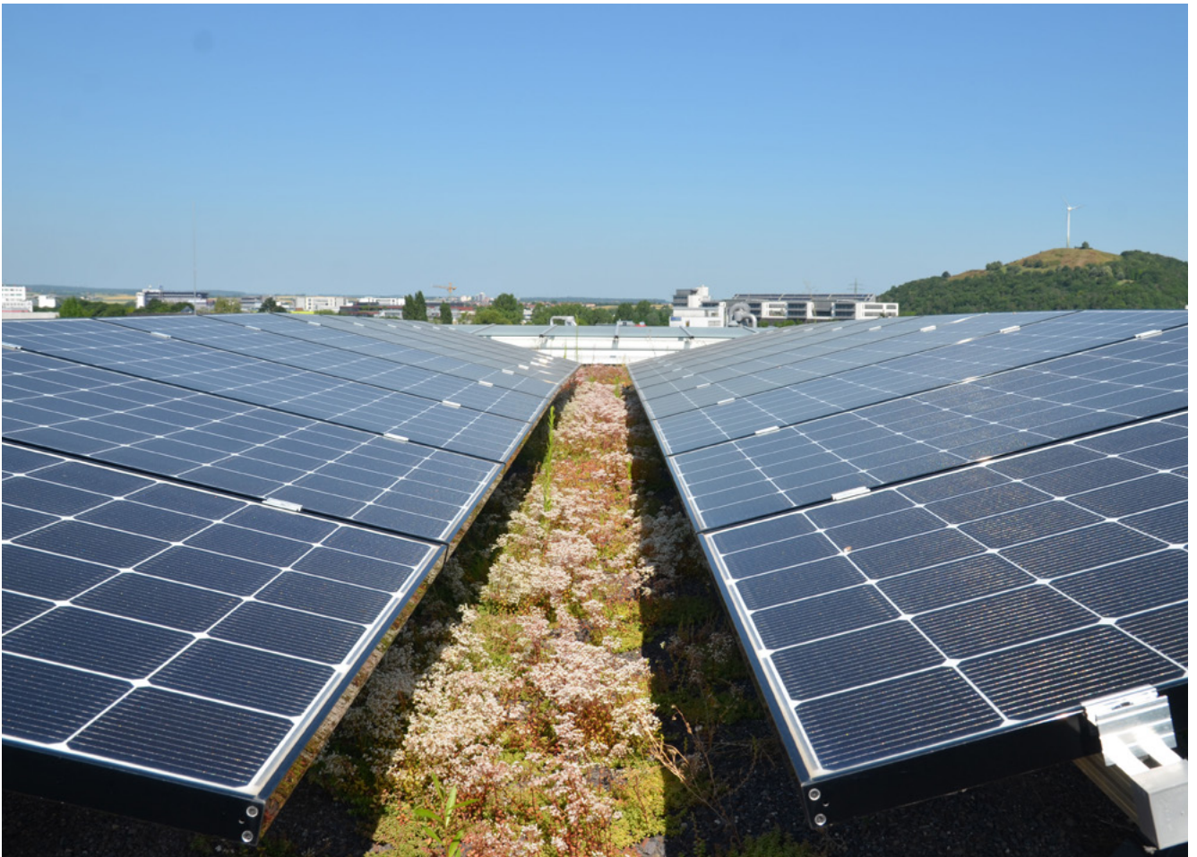
Abbildung 13: Gegen Osten/Westen ausgerichtete PV-Anlage mit minimalem Substrataufbau, Quelle: Bauder
