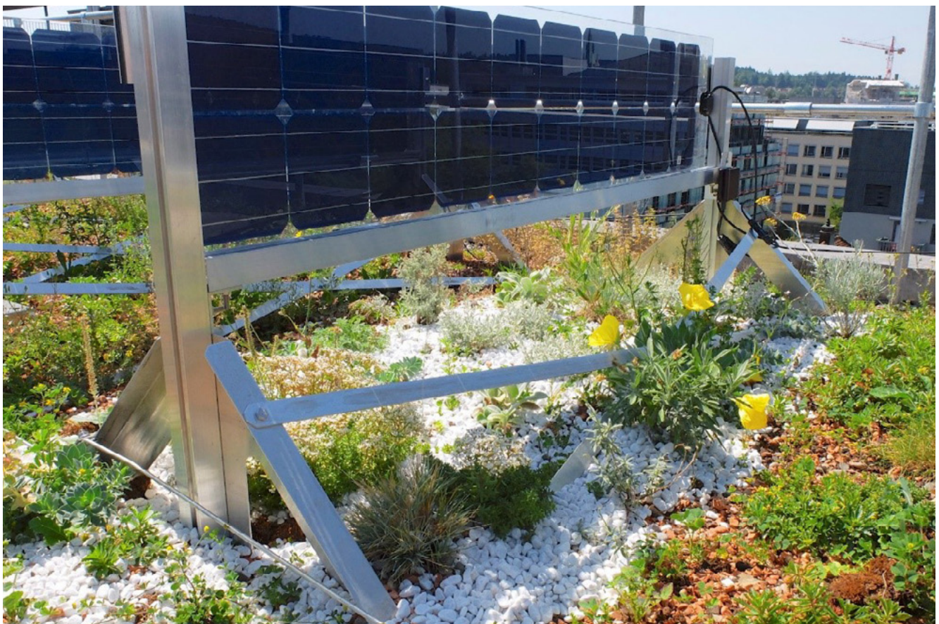
Abbildung 18: Testanlage der ZHAW, Quelle: Solarspar
