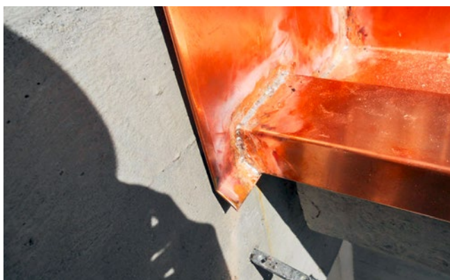
[ABB. 3] Hartlötnaht im Bereich von Beton.
