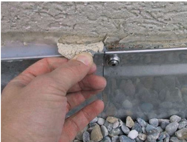
[ABB. 12] Beispiel einer unsachgemäss ausgeführten Fuge.
