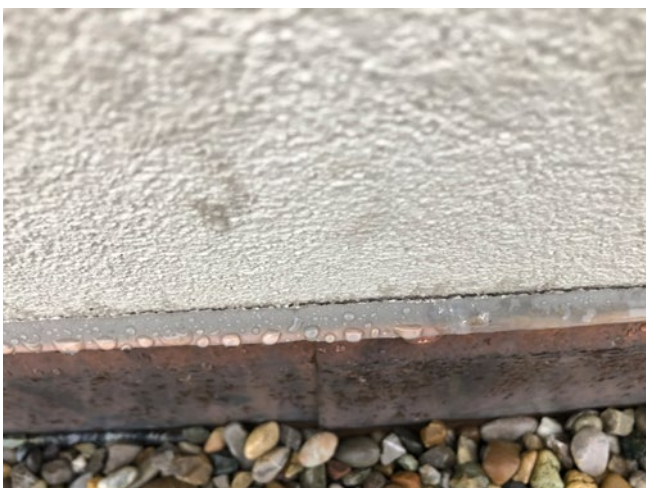
[ABB. 13] Dichtstofffuge, die sich über die Jahre abgelöst hat. Sie muss dringend erneuert werden.
