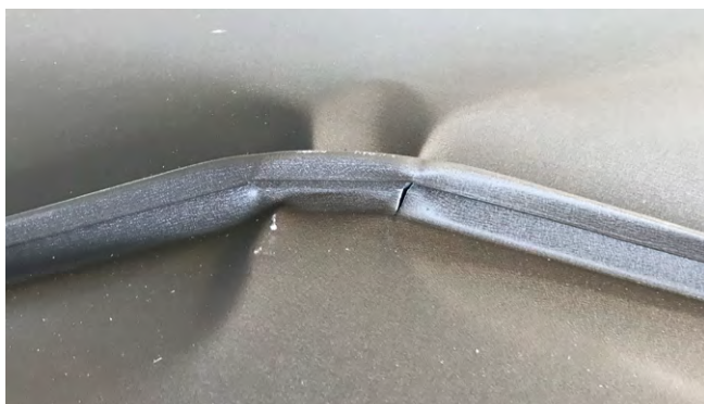
[ABB. 1] Deformation des Doppelstehfalzes aufgrund erhöhter Lasten (Windstaudruck, erhöhte Eigenlast, Schneedruck in Dachschräge) durch Solaranlagen.
