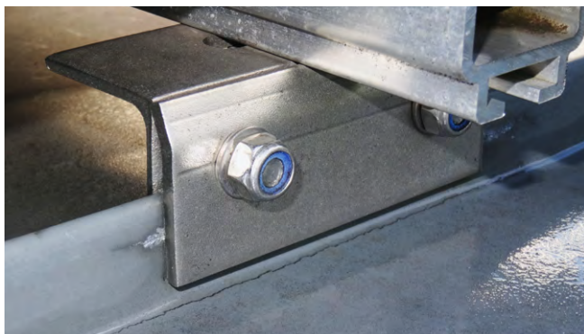
[ABB. 2] Gerissener Stehfalz aufgrund linearer Querdehnungskräfte der Solaranlagen-Unterkonstruktion.
