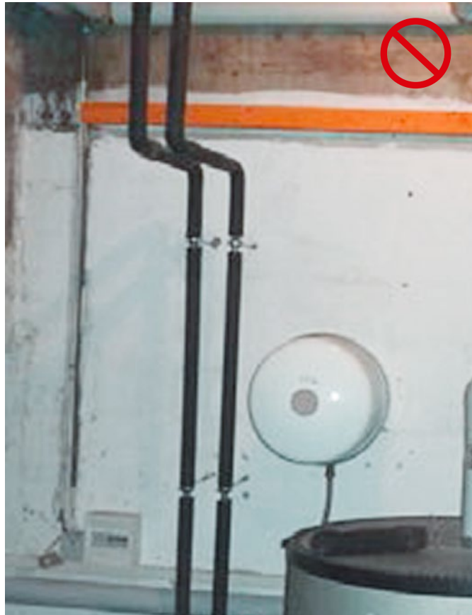
[FIG. 36] Pertes thermiques importantes : conduite longue dans un local non chauffé. Isolant élastomère trop mince (env. 13 mm), posé incorrectement par endroits, contact direct entre la conduite non isolée et son support (pont thermique).
