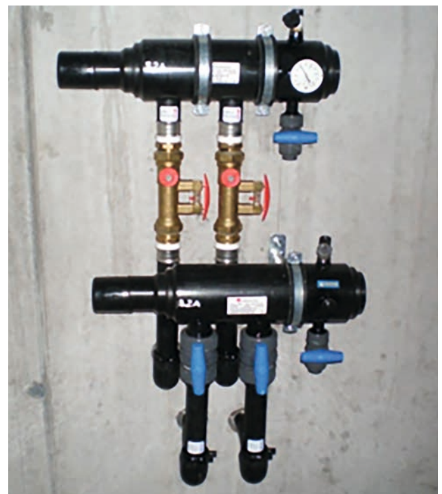
Distributeur/collecteur avec deux sondes géothermiques
