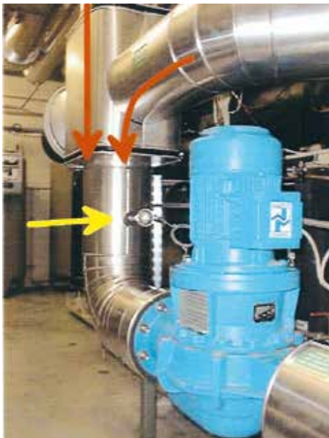
Illustration 9.22: Sonde mal placée, immédiatement après la vanne mé- langeuse et avant la pompe. Le déplace- ment du capteur après la mise en ser- vice du système prend du temps.
