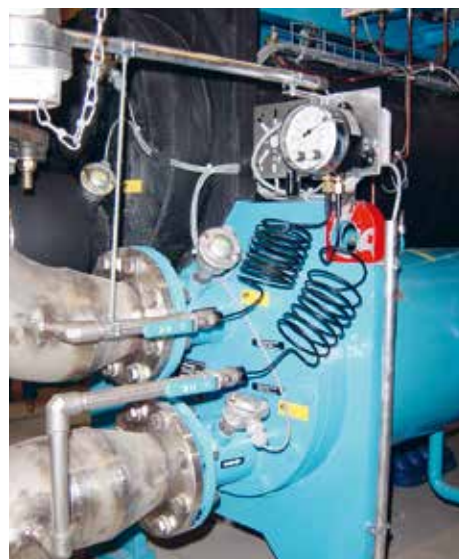
Illustration 9.16: La surveillance du débit volumique à l'aide de la surveil- lance de la pression différentielle peut être utilisée pour mesurer le flux à tra- vers l'évaporateur et ainsi le protéger du gel. La différence de pression s'affiche si- multanément.
