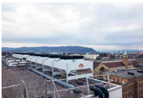
Illustration 7.15: Aéroréfrigérant sec sur la toiture. (Source: CTA)
