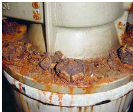
Illustration 8.29: Dommages dus à la corrosion sur la conduite d'eau froide (sous l'isolation).
