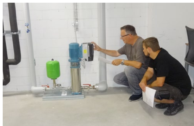
[FIG. 3] Selon l'ordonnance sur l'eau potable, le propriétaire/l'exploitant de l'installation d'eau potable est responsable de son exploitation correcte. Pour qu'il puisse s'acquitter de ses obligations, le professionnel ayant monté l'installation est tenu de l'instruire. L'instruction comprend la remise des documents relatifs à l'installation ainsi qu'une explication avec procès-verbaux d'instruction.
