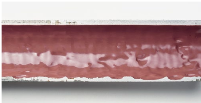
[FIG. 2] Diminution de l'épaisseur de la paroi due à la corrosion.
