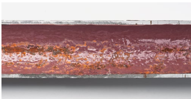
[FIG. 3] Nettoyage et recouvrement insuffisants du tuyau.
