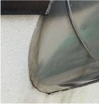
Illustration 1 Photo d'un dommage, absence de déflecteur
