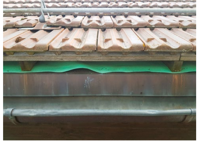
Illustration 17 : lé de sous-couverture insuffisamment protégé
