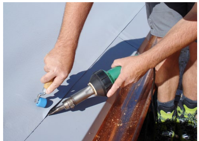
Illustration 13 : lé de sous-couverture sur bavette cachetée. Les joints proches de la bavette doivent être soudés.
