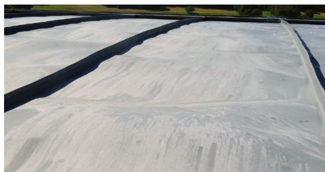
[FIG. 1] Bande de tôle soulevée par le vent en raison d'un entraxe trop important.
