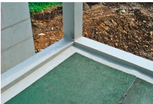
[FIG. 7] Etanchéité à la résine synthétique liquide, qui permet d'éviter les techniques avec flamme nue.
