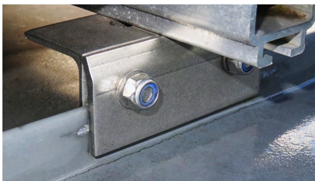
[FIG. 2] Joint debout fissuré en raison des forces de dilatation transversales linéaires de la sous-construction de l'installation solaire.
