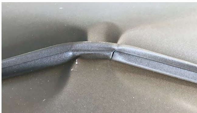
[FIG. 1] Déformation de l'agrafe debout double due à des charges accrues (pression du vent, charge propre accrue, pression de la neige dans la pente du toit) transmises par l'installation solaire.
