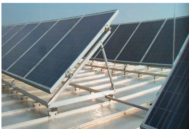
[FIG. 3] Les installations surélevées génèrent des charges supérieures aux installations parallèles, car elles offrent une plus grande surface de prise au vent. De plus, de la neige peut s'accumuler derrière les modules et ainsi accroître la charge sur les pattes. Le calcul doit alors être réalisé au cas par cas par un ingénieur civil.
