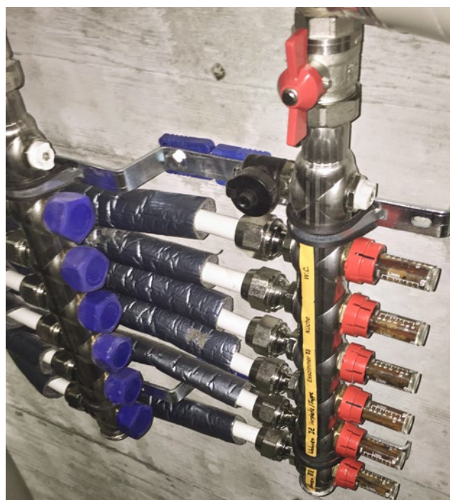
[FIG. 3] Indicatori di flusso sporchi dopo due anni di esercizio.
