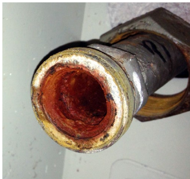
[FIG. 2] Residui di corrosione in un distributore per riscaldamento a pavimento.
