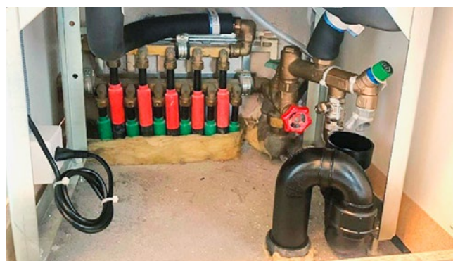
[FIG. 4] Impianto sotto lo scaldacqua a pompa di calore.
