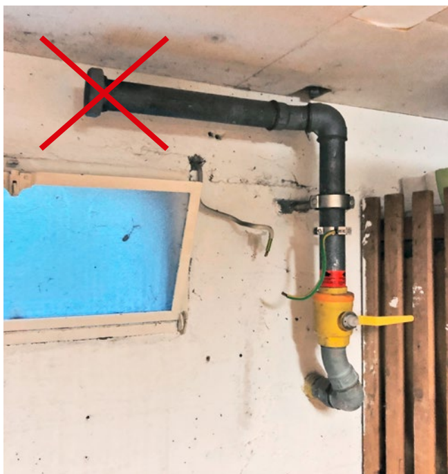
[FIG. 3] Allacciamento del gas non lasciato in sicurezza. Manca il tappo.
