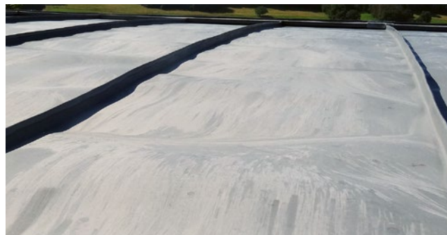
[FIG. 1] Gonfiamento del nastro di lamiera dovuto alle forze del vento a seguito di un interasse eccessivo.
