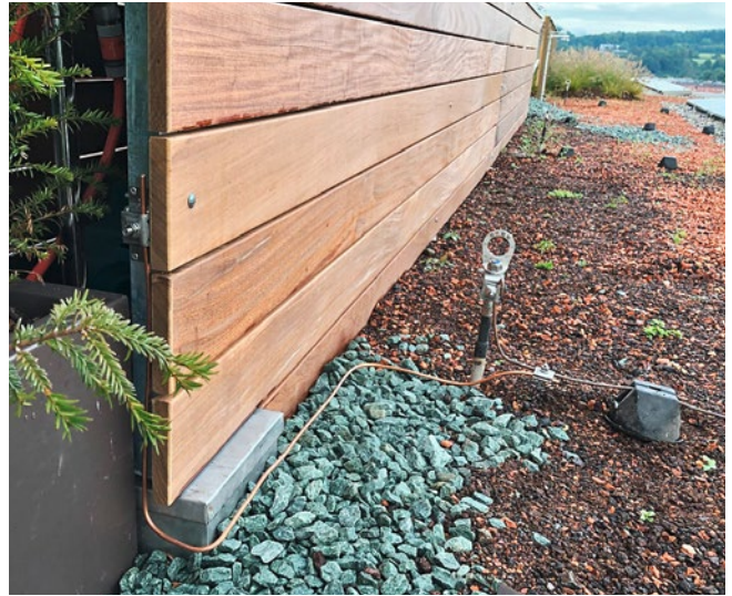
[FIG. 7] Punto di ancoraggio singolo raccordato al sistema di protezione contro i fulmini.
