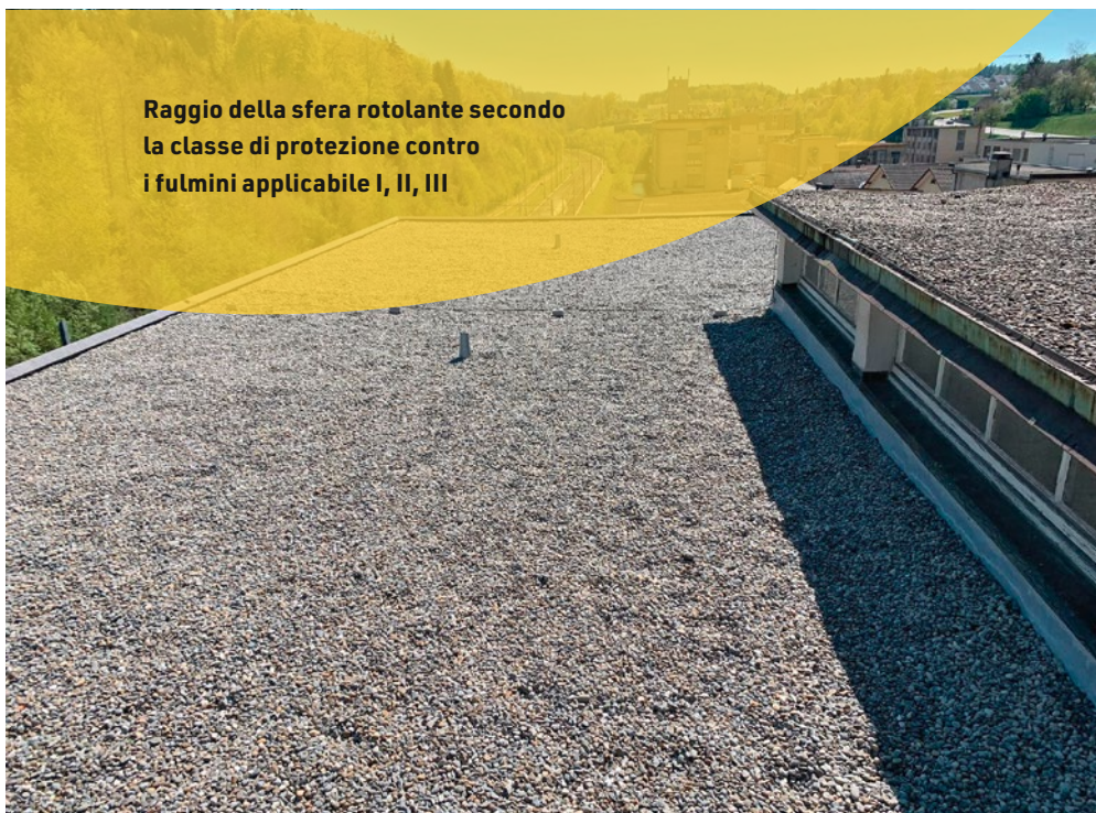
[FIG. 1] Il punto di ancoraggio singolo è protetto dal raggio della sfera rotolante e non deve essere raccordato.
