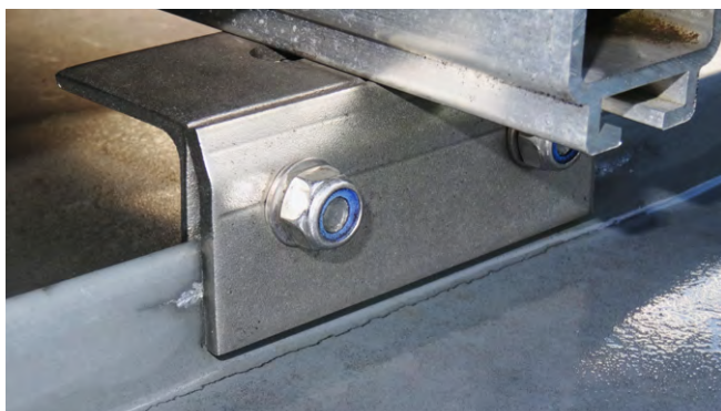
[FIG. 2] Crepa in un'aggraffatura verticale a causa delle forze di dilatazione trasversali esercitate linearmente dalla sottostruttura dell'impianto solare.
