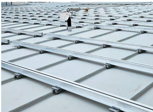
[FIG. 11] Sottostruttura con evidenti interruzioni dei profili.
