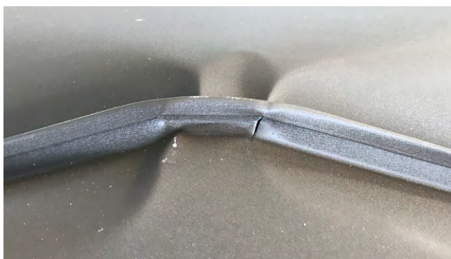
[FIG. 1] Deformazione dell'aggraffatura verticale doppia a causa dell'aumento dei carichi dovuti agli impianti solari (pressione dinamica del vento, incremento del peso proprio, pressione della neve sulla falda).
