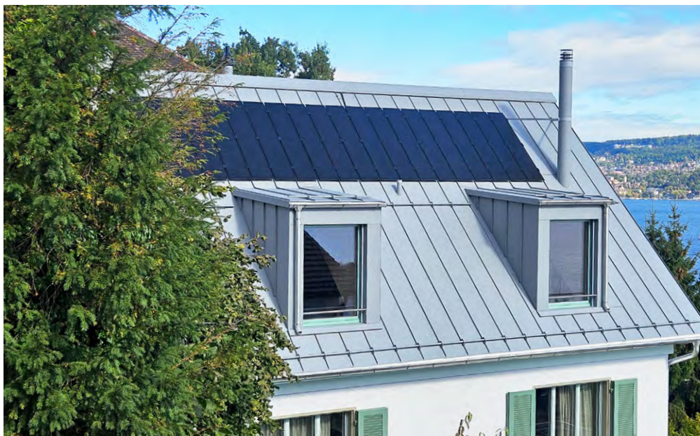
[FIG. 10] Impianto solare con sistema di trattenuta della neve.
